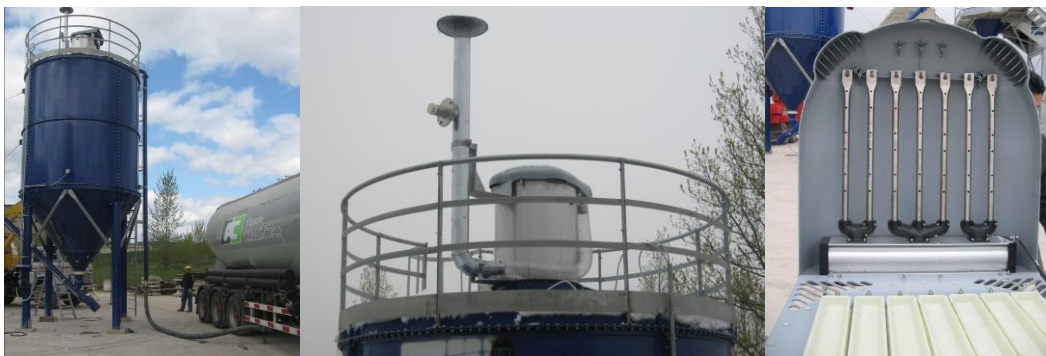
1.3.10 pav. Cemento užkrovimas į silosus pneumatinais siurbliais (kairėje), cemento dulkių filtravimo sistema ir išmetimo vamzdys (per vidurį), filtro kasečių valymo reaktyvine suspausto oro srove sistema (dešinėje).
