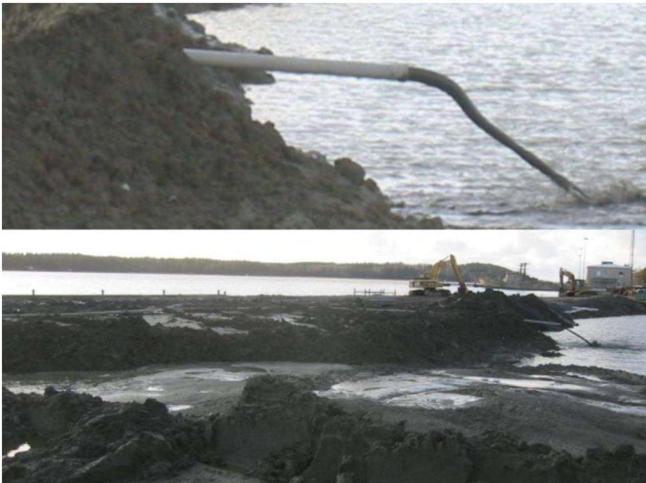
1.3.31 pav. Paruošto mišinio transportavimas į aikštelę betono siurbliais ir masės paskirstymas aikštelės teritorijoje (pagal STABLE. LIFE06 ENV/FIN/195).
